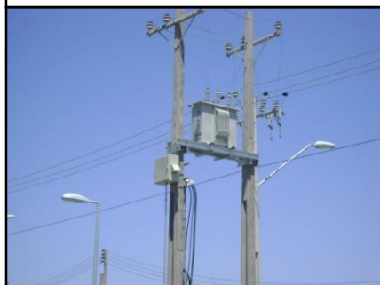
Centro de Salud Familiar Santa Hualpén – Subestación 250 KVA
