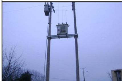
Centro de Salud Familiar Hualpencillo – Subestación 250 KVA
