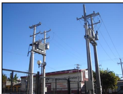
Hospital de Talca – Subestación 250 KVA
