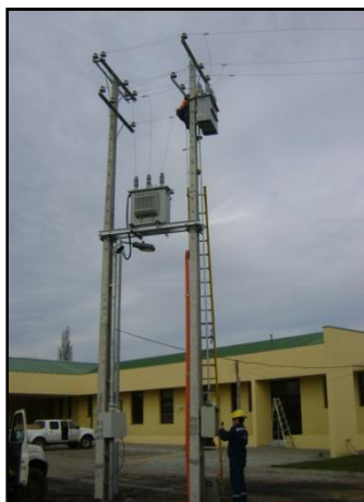
Centro de Salud Familiar Santa Fe – Subestación 250 KVA
